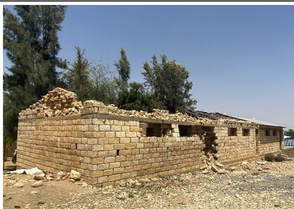
紛争で破壊されたネガシ小学校の校舎
